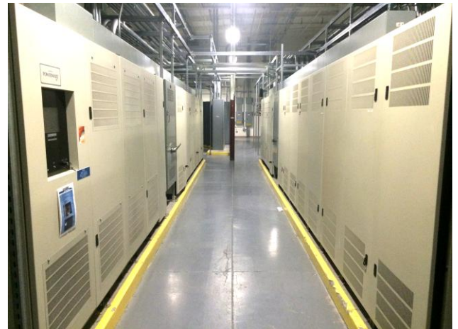
7 \pm 625 kVA UPS
